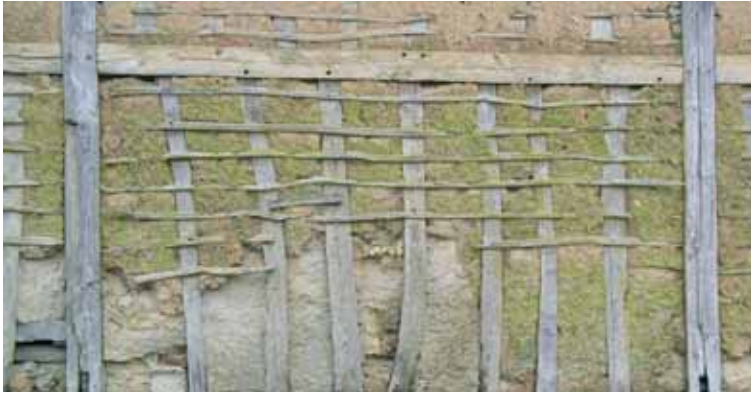
L'enduit dégradé laisse apparaître la structure bois et le torchis sous-jacents (Pays de Bray)
