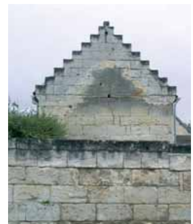
Pignon d'une maison en pierre de taille calcaire à « pas de moineaux* » (Courtieux)
